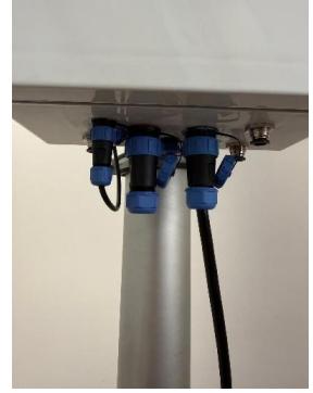
Güç kaynağına bağlantı
