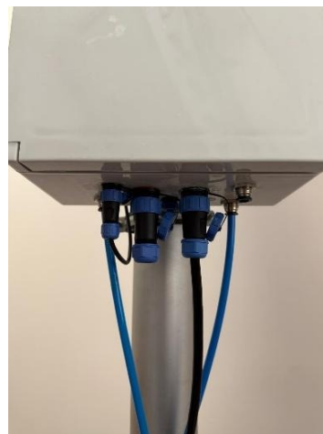
Anslutning till mastens luftintag
