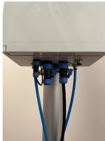
Tilkobling til mastens luftinntak
