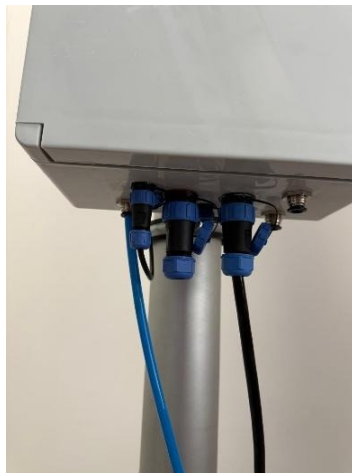
Tilkobling til kompressoren
