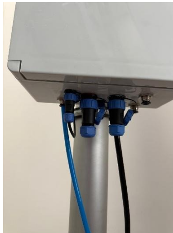
Collegamento al compressore
