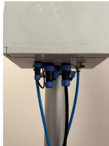
Collegamento all'ingresso dell'aria della torre
