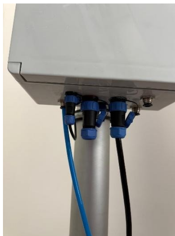
Raccordement au compresseur
