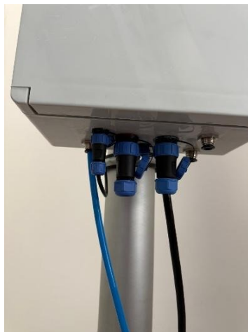
Conexión al compresor
