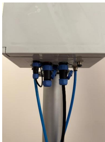
Connectie met de luchtinvoer voor mast
